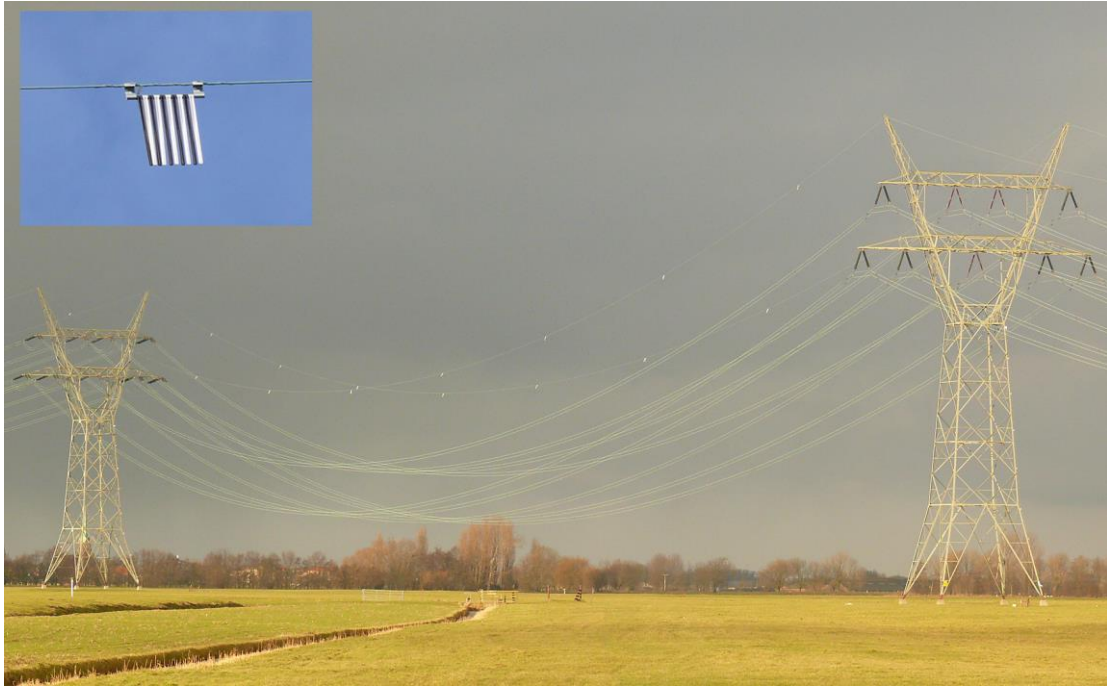
Figure 20 : Ligne haute tension (150 kV) aux Pays-Bas avec ailettes aviaires (birdflappers) (voir flèches) placées à intervalles réguliers sur les deux câbles de terre comme dérouteurs de vol, voir également l'encadré 1 (Photo: Bureau Waardenburg).
