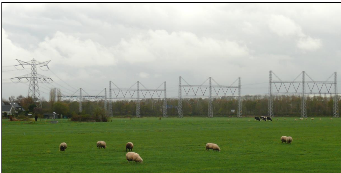
Figure 17 : Ligne de 380 kV, les câbles étant suspendus plus bas sur des portiques sur un seul plan horizontal afin de réduire les risques de collisions pour le grand cormoran ( Phalacrocorax carbo ), la spatule blanche ( Platalea leucorodia ) et le héron pourpré ( Ardea purpurea ) passant tous les jours au-dessus de cette ligne en faisant des aller-retour entre la colonie en reproduction et les zones d'alimentation, Muiden, les Pays-Bas (Photo : Bureau Waardenburg).
