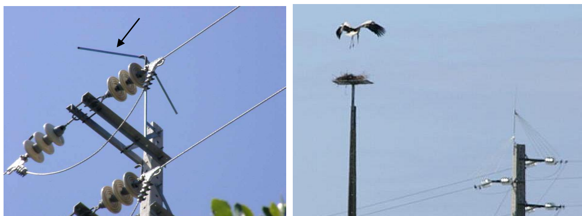
Figure 11 : Poteaux électriques avec chevron symétrique (voir flèche) au sommet comme dispositif d'exclusion (Photo : EDP-Distribution, Portugal) ; et poteaux électrique avec pointe d'exclusion d'oiseaux et poteau de nidification pour cigognes blanches juste à côté).
