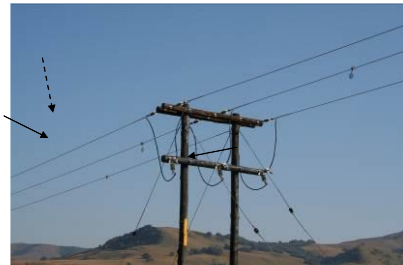
Figure 8 : Structure tendue sûre, avec câbles de liaison isolés (flèches noires) et isolateurs suffisamment longs (flèche en pointillés) (Photo: EWT-WEF).
