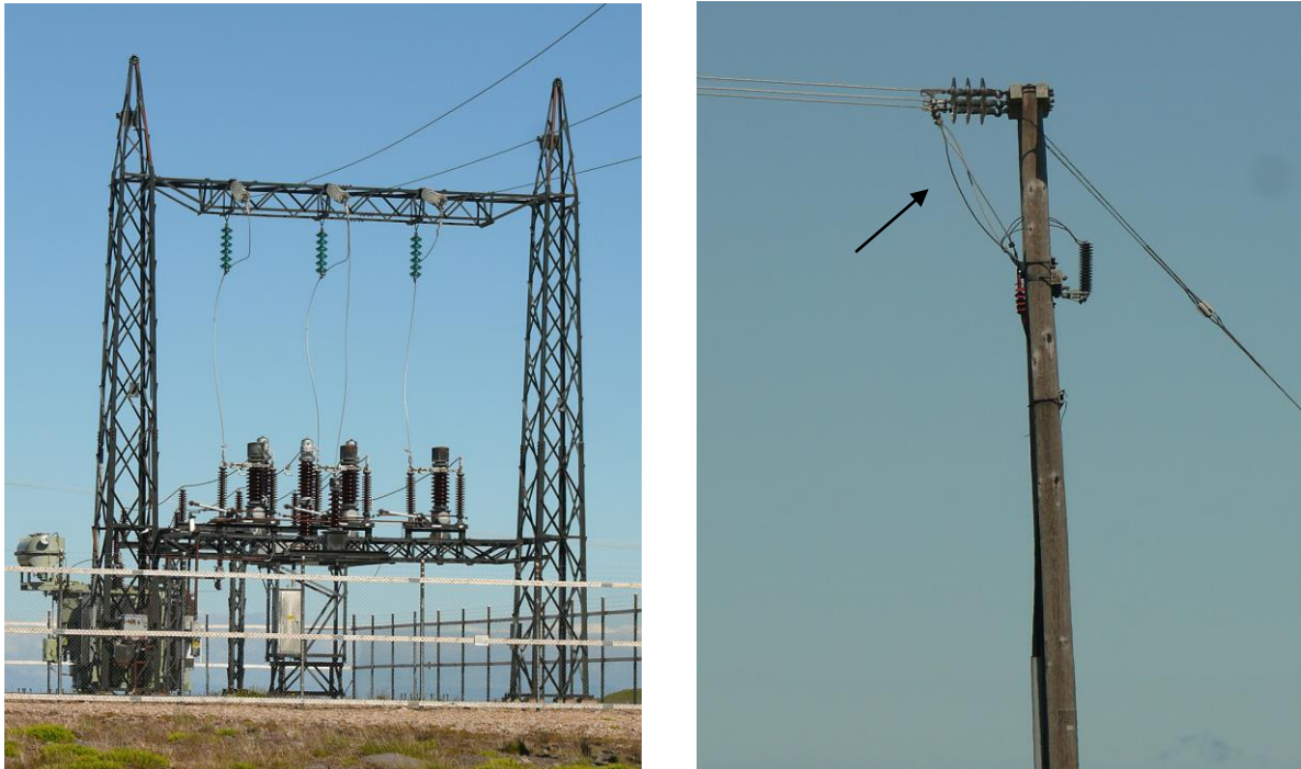
Figure 3 : À gauche : Sous-station électrique où se côtoient des éléments sous tension potentiellement dangereux pour les oiseaux. Les modifications pourraient inclure l'isolation des câbles qui pendent verticalement et davantage d'espace entre les pièces sous tension. À droite : Pylône d'extrémité de ligne électrique ; les câbles de liaison (flèche) placés sous les conducteurs et les isolateurs font plus de 60 cm de long, offrant un perchoir au sommet du pylône (Photos : Bureau Waardenburg).
