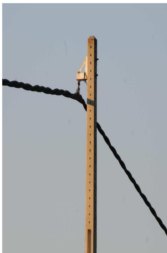
Figure 9 : Câble moyenne tension entièrement isolé, en Espagne, suspendu à un poteau en ciment et ne nécessitant pas d'isolateurs (source : Haas, 2011).
