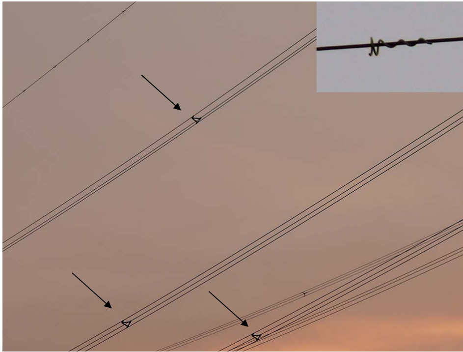
Figure 6. Lignes de transport à haute tension (de 380 kV) avec entretoises (indiquées par les flèches) pour séparer les câbles sous tension d'un même groupement. Le câble isolé et fin dans le coin en haut à gauche de la photo est le câble de garde qui est généralement positionné au dessus des câbles conducteurs sous tension. Dans le cas présent, il a été équipé de petites spirales (appelées « queues de cochon », voir encadré) pour le rendre plus visible par les oiseaux (Photo: Bureau Waardenburg).
